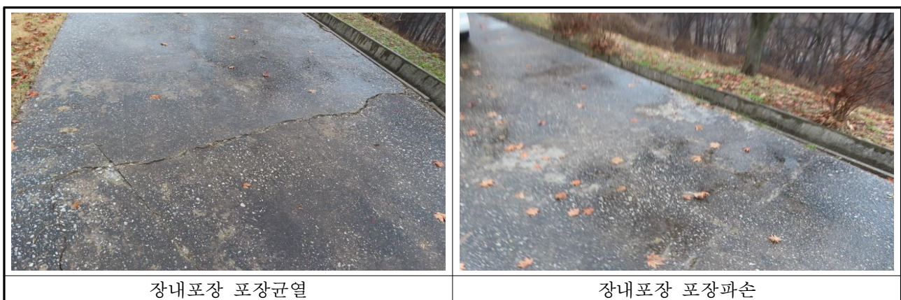
【사진 3.10】도로포장 손상사진
