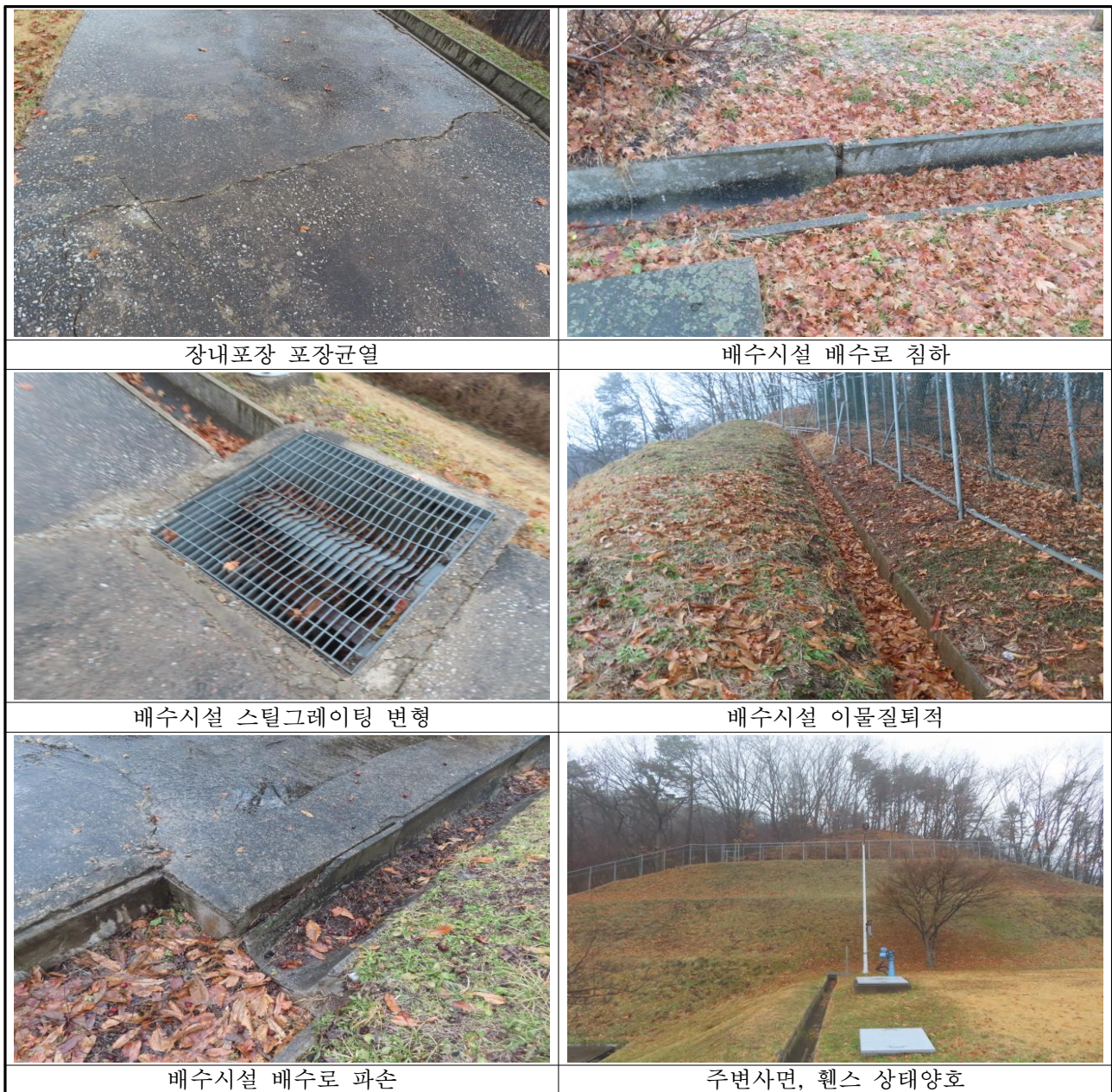
【사진 3.8】 기타 부대시설 손상사진
