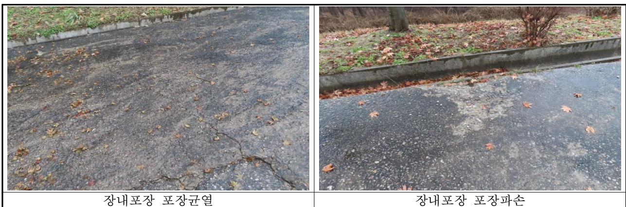
【사진 3.8】 기타 부대시설 손상사진 (계속)
