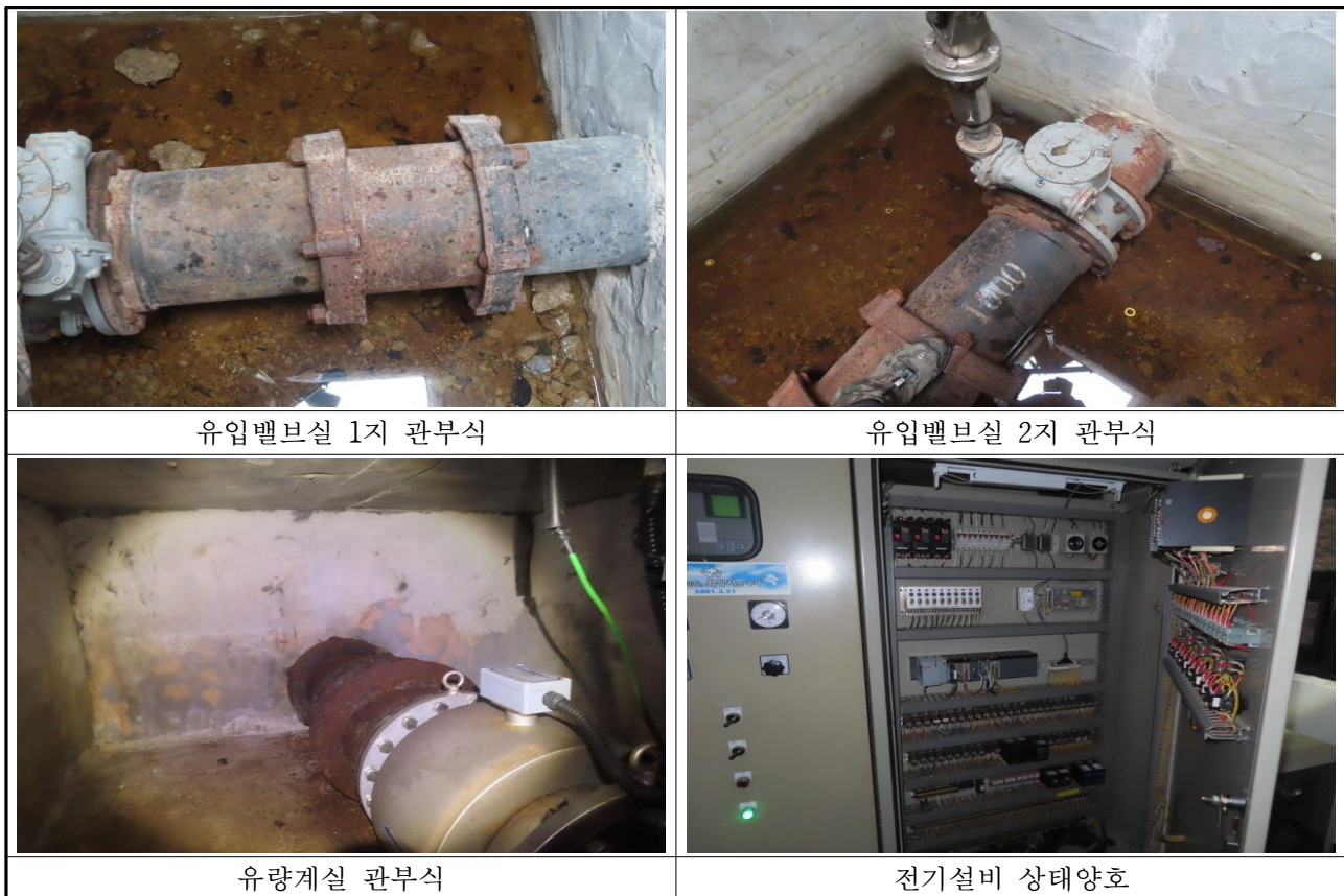
【사진 3.6】 기전설비 손상사진
