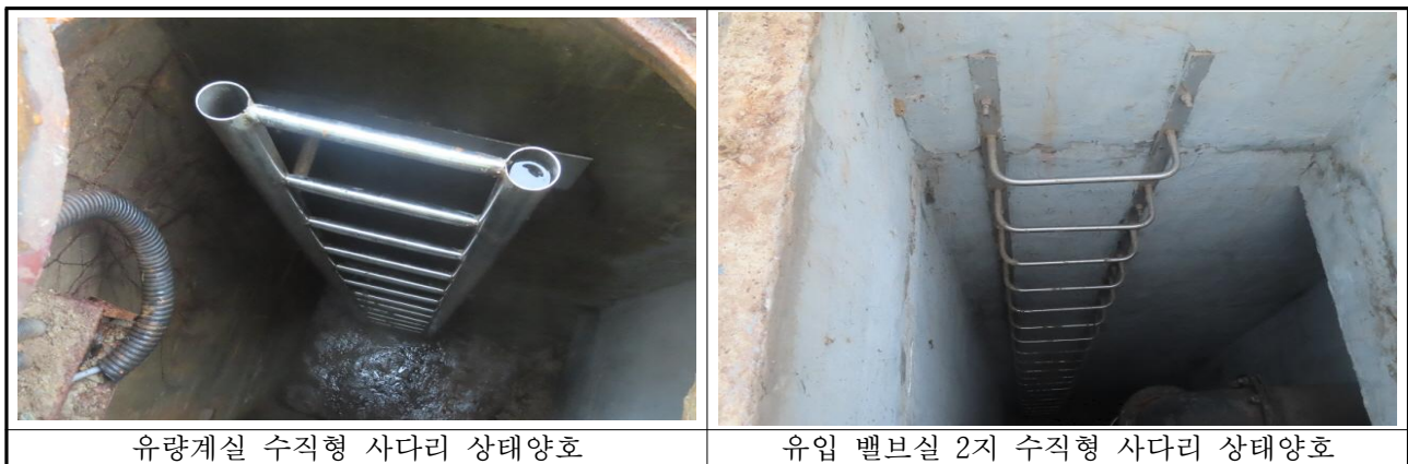
【사진 3.9】추락방지시설 손상사진
