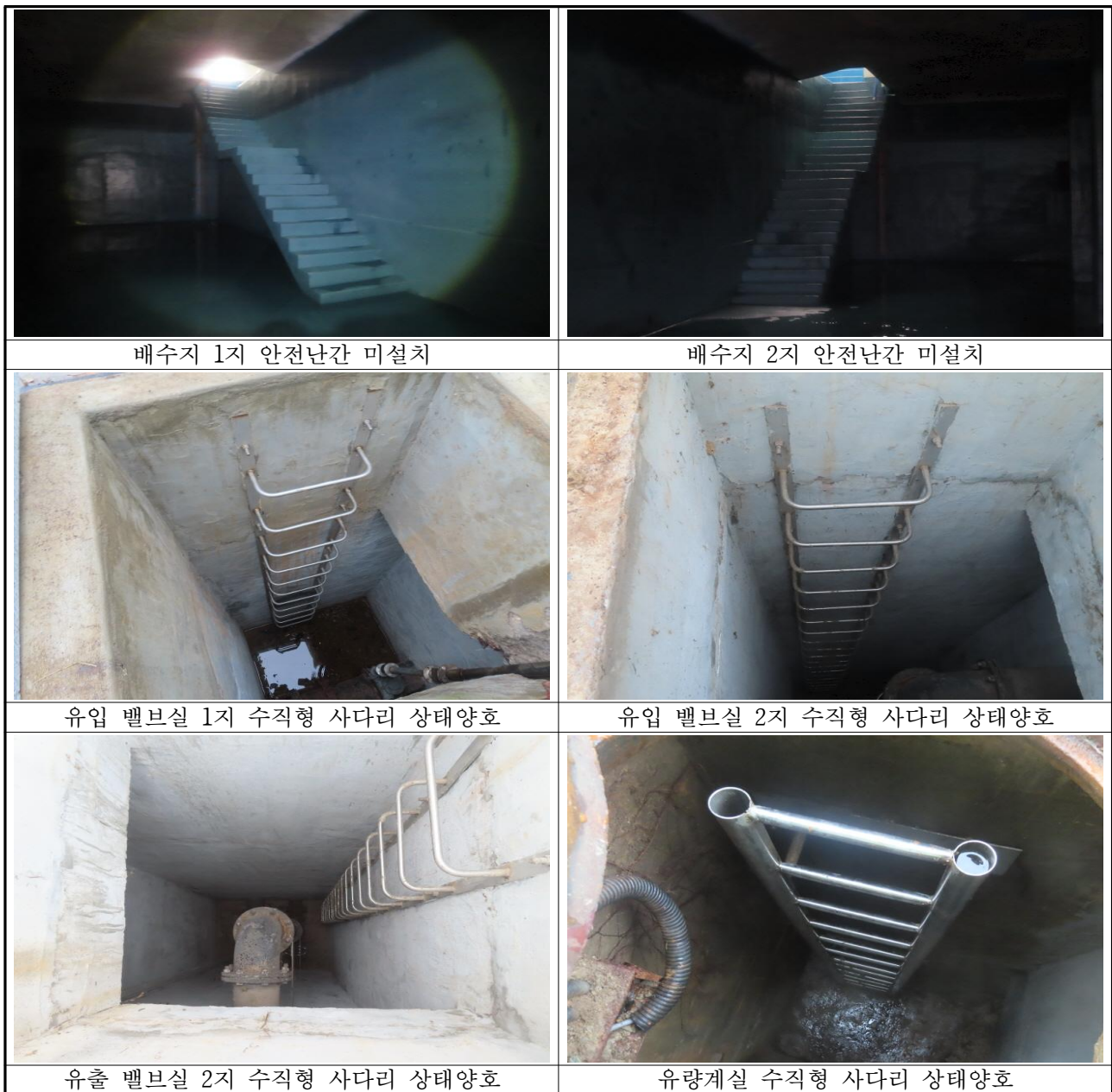
【사진 3.7】 안전시설(점검로) 손상사진
