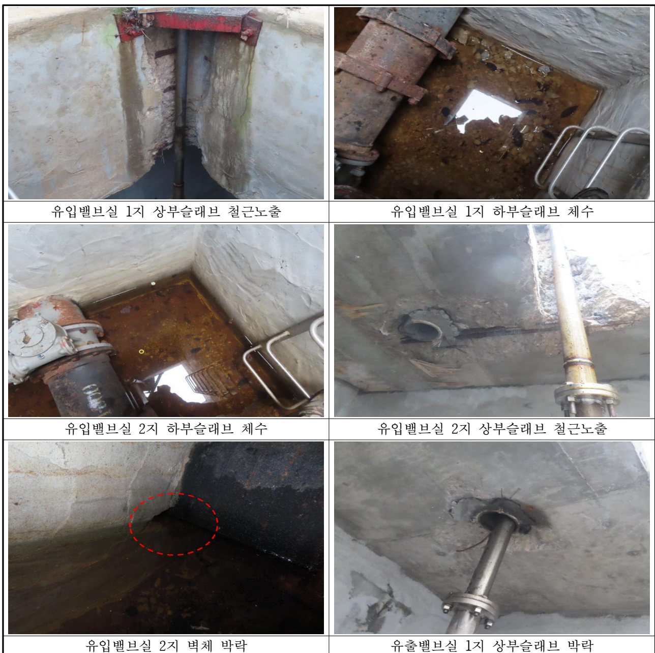
【사진 3.4】 유입 · 유출 밸브실, 유량계실 손상사진 (계속)
